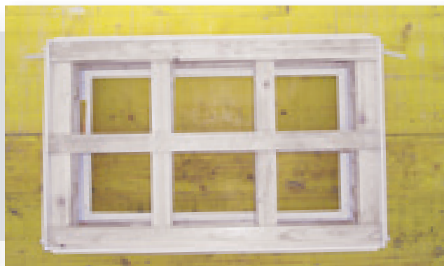
2. Posizionare la finestra (preferibilmente senza il serramento) e fissarla con un chiodo. Inserire i telai di rinforzo per il getto.
